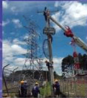
Transformador convencional, Nodo San Bernardino Interhexa
