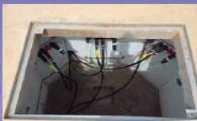
Caja de distribución Subterránea , Auralac S.A
