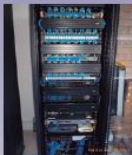
Rack Datos, Empacor S.A
