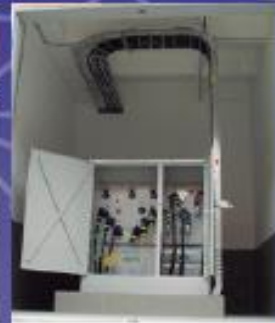
Transformador pedestal Pelco S.A.
