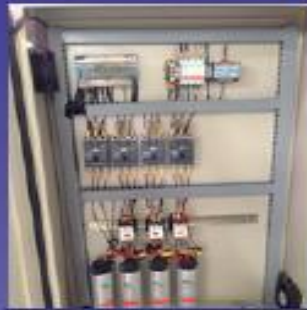
Banco condensadores, Productos Bary S.A
