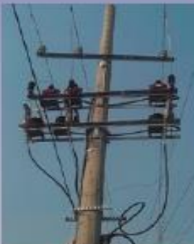
Medida exterior 13.2kV, Internexa nodo copey
